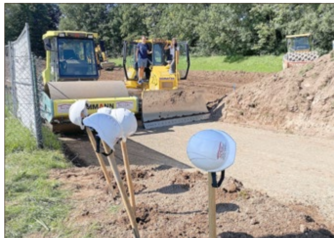
„An die Schaufel - fertig - los“ - Mit dem offiziellen Spatenstich begannen die Bauarbeiten zum neuen Skate- und Freizeitareal „Haselpipe“, dem größten Projekt des Kinder- und Jugendbeirates.
